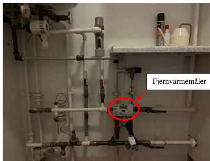
Installationen i bryggerset, som de fleste ser ud
